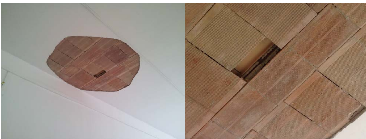
Sfondellamento del solaio in latero-cemento, la problematica che emerge con la rimozione dello strato di intonaco.
