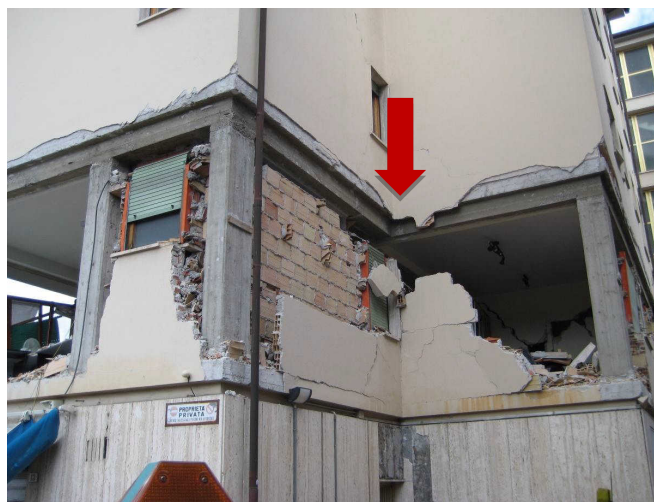
Figura 3 – Danneggiamento significativo della struttura con crolli dei tamponamenti esterni (Aquila, 2009).
