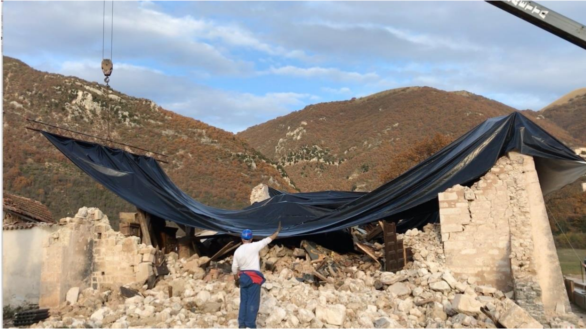
La Chiesa di San Salvatore a Campi di Norcia (PG) dopo gli eventi sismici del 2016 (foto tratta da un video dell'Ing. R. Vetturini).
