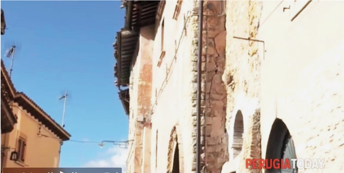
Figura 6. Lesioni sulla facciata della Chiesa di Santa Maria di Piazza subito dopo le scosse del 26 ottobre 2016 e prima del sisma del 30 ottobre 2016. Immagine estratta da un video disponibile sul sito www.perugiatoday.it .
