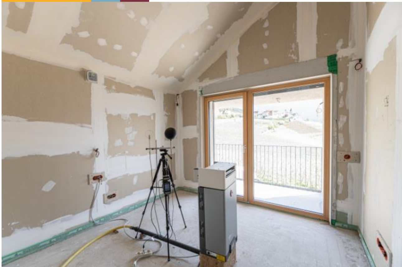
A parete, uno dei 36 sensori scientifici nominati, in centro alla stanza una stazione microclimatica per il rilievo del livello di comfort e un umidificatore utilizzato per la simulazione di presenza umana
