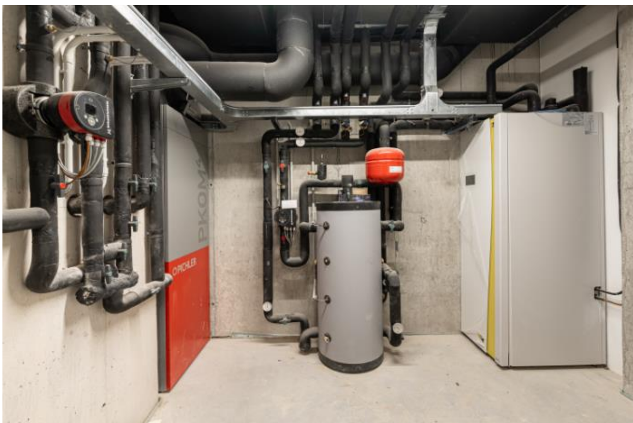
Locale impianti di uno degli edifici monitorati, parte dei dati rilevati proviene dalle macchine stesse, parte da sonde aggiuntive poste lungo le tubazioni
