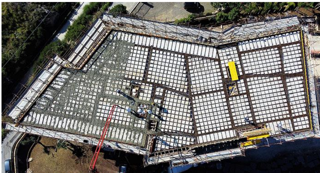
Figura 2: Vista dall'alto dell'installazione del Sistema Cube di SCF.
