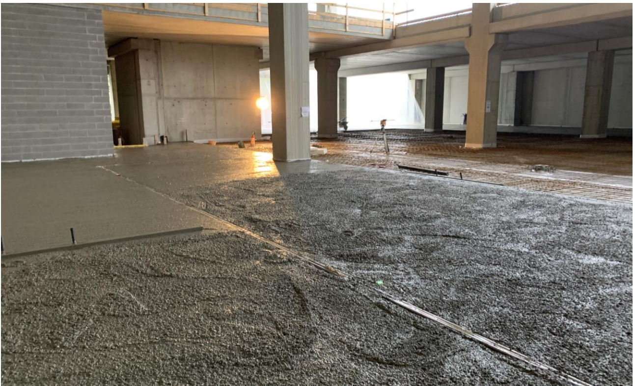
Figura 7. Fasi di getto e stesura della pavimentazione fibrorinforzata con FIBRAG® POLY: PSF 55-TP
