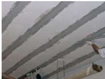
Fig. 4 – Rinforzo a flessione dei travetti di un solaio latero-cemento mediante lamine pultruse in carbonio.
