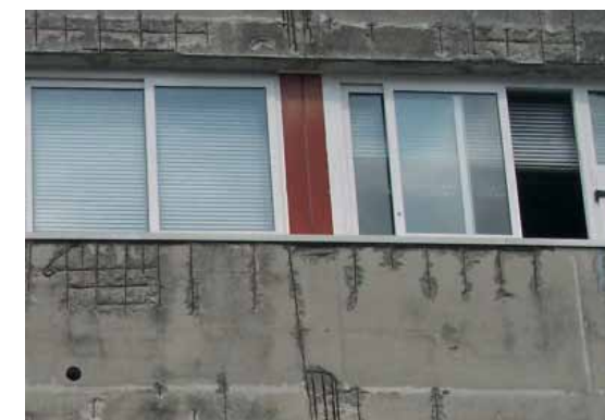
Figura 1. Corrosione promossa da carbonatazione in classe di esposizione XC4
