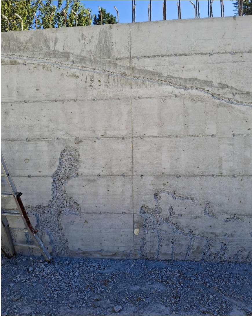
Foto 2: apertura delle disomogeneità del calcestruzzo
