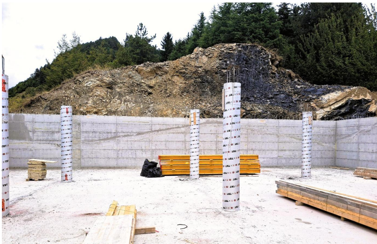
Foto 1: vasca appena realizzata, con evidenti non conformità di getto
