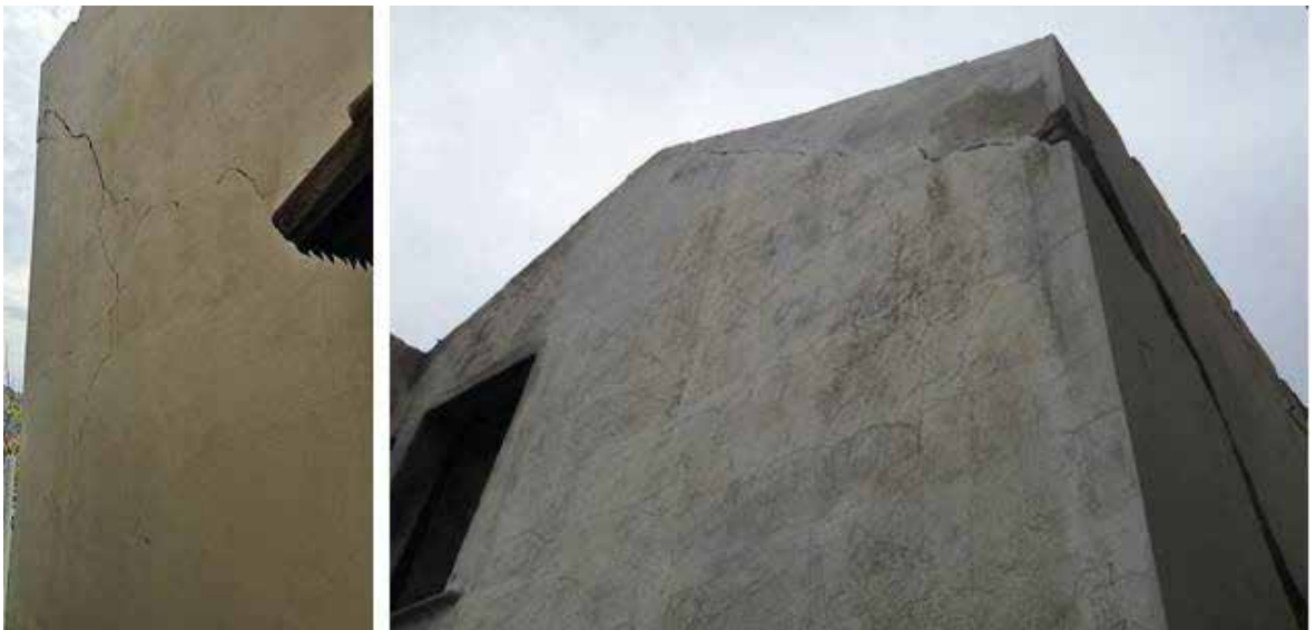
Figura 1 e 2 – Lesioni indotte dal crollo della copertura per incendio e da disomogeneità costitutive della muratura (fascia sommitale con tipologia costitutiva differente – laterizio semipieno – rispetto alla muratura sottostante – pietra a conci sbozzati).
