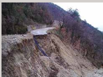
Figura 2 – Tratto di strada interrotta
