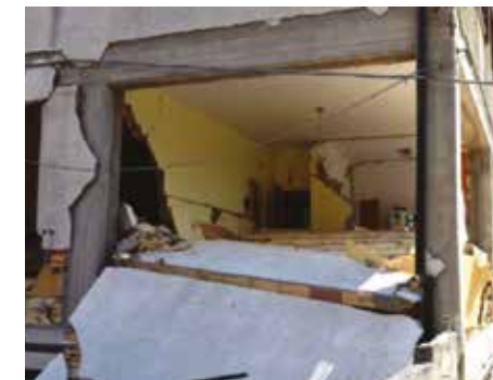
Figura 1 – Esempio di espulsione delle tamponature esterne in un edificio in c.a.
