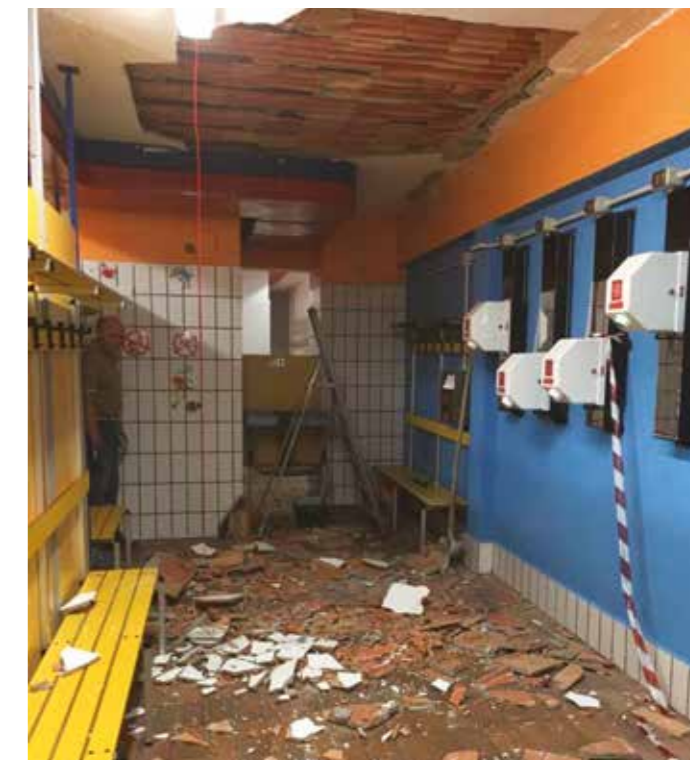
Figura 1 – Esempio di danni causati dal fenomeno di sfondellamento
