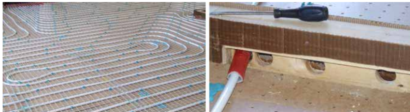
Figura 1 – Ristrutturazione asilo nido ad Arezzo. Sistema radianti a pavimento. Fonte: Eurotherm
