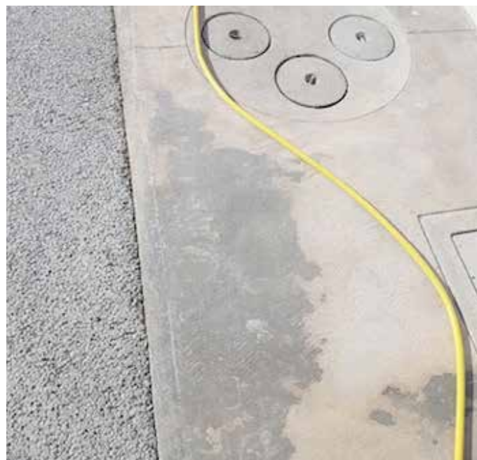
Macchie nere su superficie non lavorata a macchina
