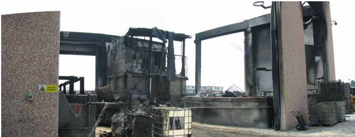
Figura 1 – Impianto industriale in ca e cap prefabbricato completamente distrutto da un incendio [foto dell'Autore]
