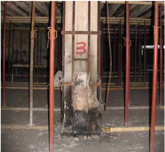
Figura 2 – Pilastro ed impalcato in c.a. danneggiato da incendio [foto dell'Autore]
