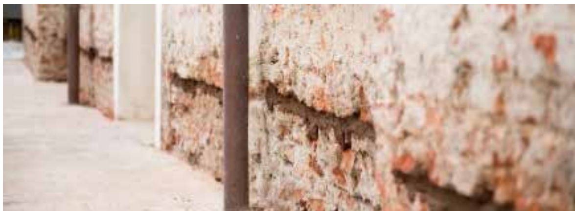
Figura 1 - Particolare di un impianto elettrosmotico (immagine gentilmente concessa da www.elosystem.it )
