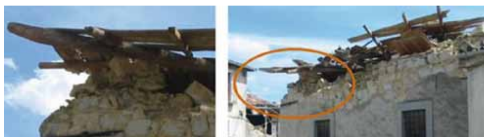
Figura 1 – Abruzzo 2009: effetto d'implosione della copertura
