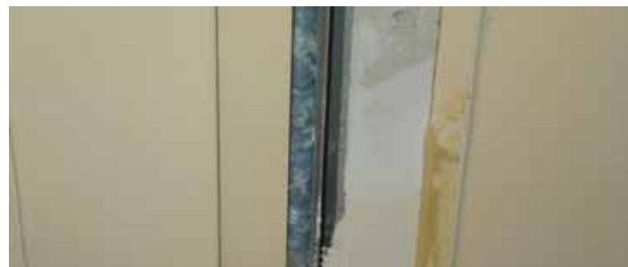
Figura 2 – mancata sigillatura del giunto primario, il giunto secondario si presenta sigillato
