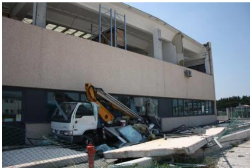
Figura 6. Caduta di pannelli prefabbricati orizzontali.
