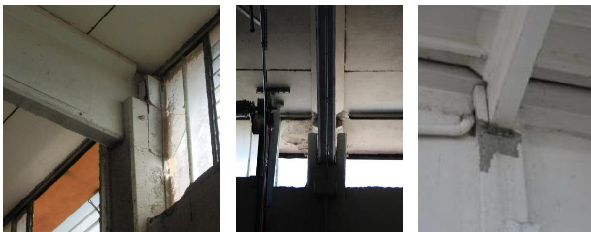
Figura 2 – Danneggiamenti del collegamento trave pilastro
