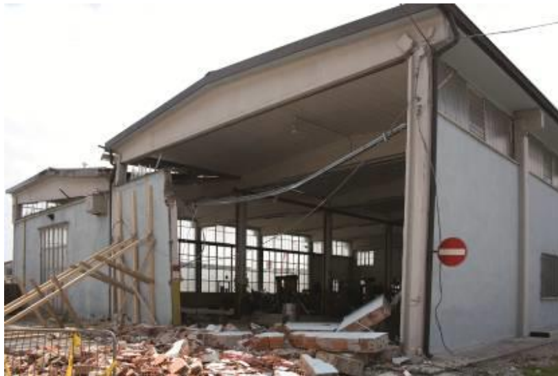
Figura 5 Collasso di tamponamenti perimetrali in laterizio.
