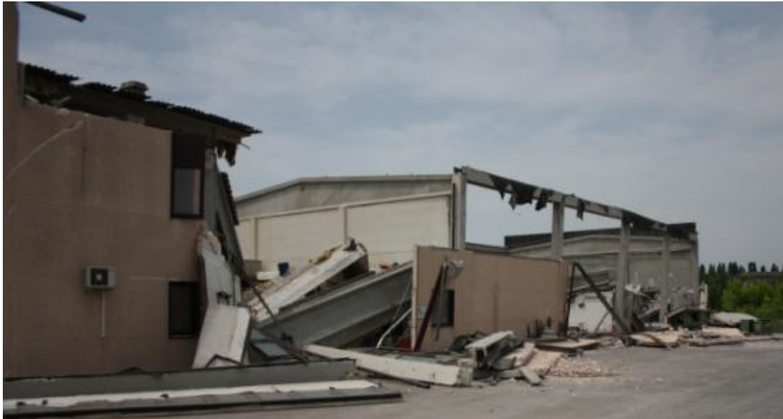
Figura 3. Rotazione dei pilastri alla base per problema in fondazione
