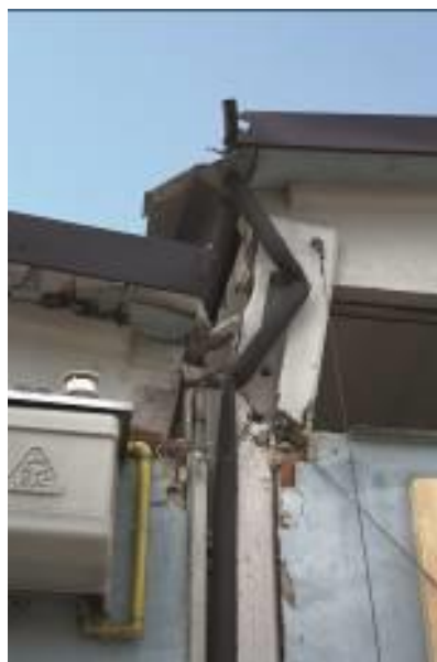
Figura 4.- Danneggiamento del pilastro corto per presenza di tamponatura e finestratura a nastro.
