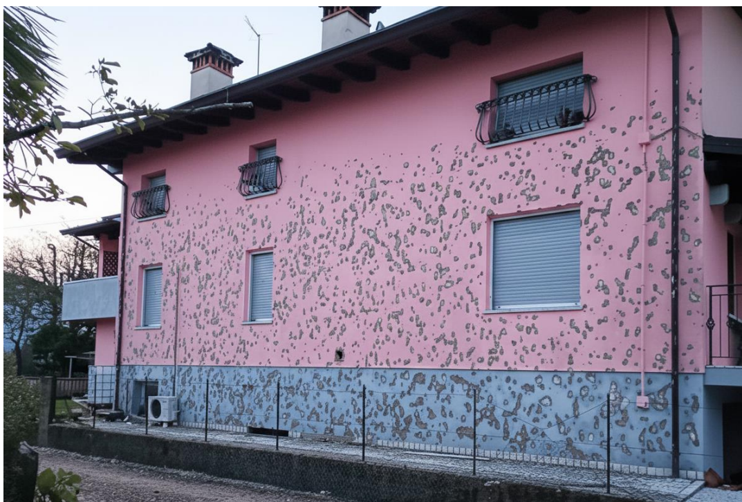
Segni evidenti di una violenta grandinata sulla facciata di un'abitazione
