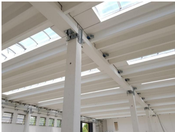
Collegamenti con dispositivi Sismocell degli elementi in copertura - Sismocell
