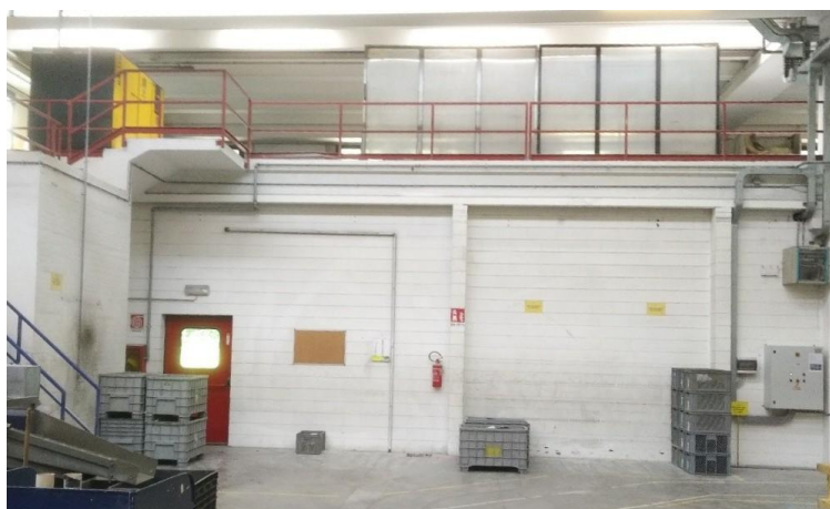
Irregolarità generata da un piano intermedio con tamponamenti, all'interno del capannone - Sismocell
