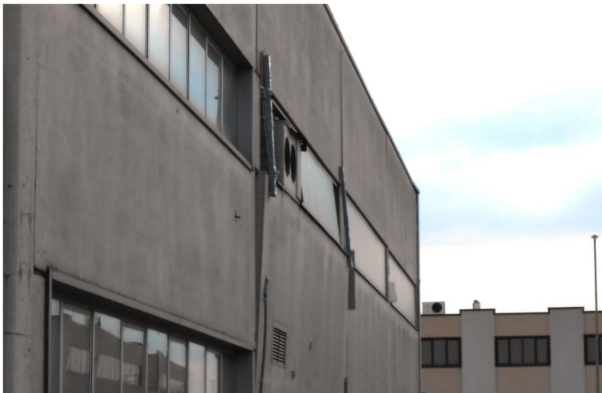
Pannello orizzontale sottofinestra, trattenuto dal completo ribaltamento, dopo il sisma del 2012 (Z.I. Mirandola) @Sismocell
