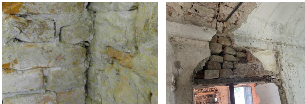
Figura 7 –Carenze costruttive: a) mancanza di adeguato ammorsamento delle murature; b) Voltini incoerenti
