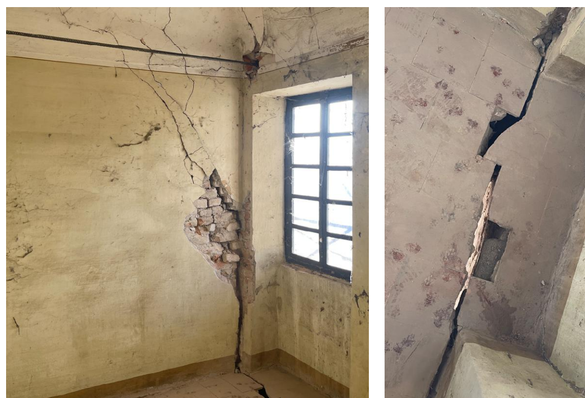
Figura 8 – Deformazione della facciata e conseguenti fessurazioni nelle volte, pareti e pavimenti
