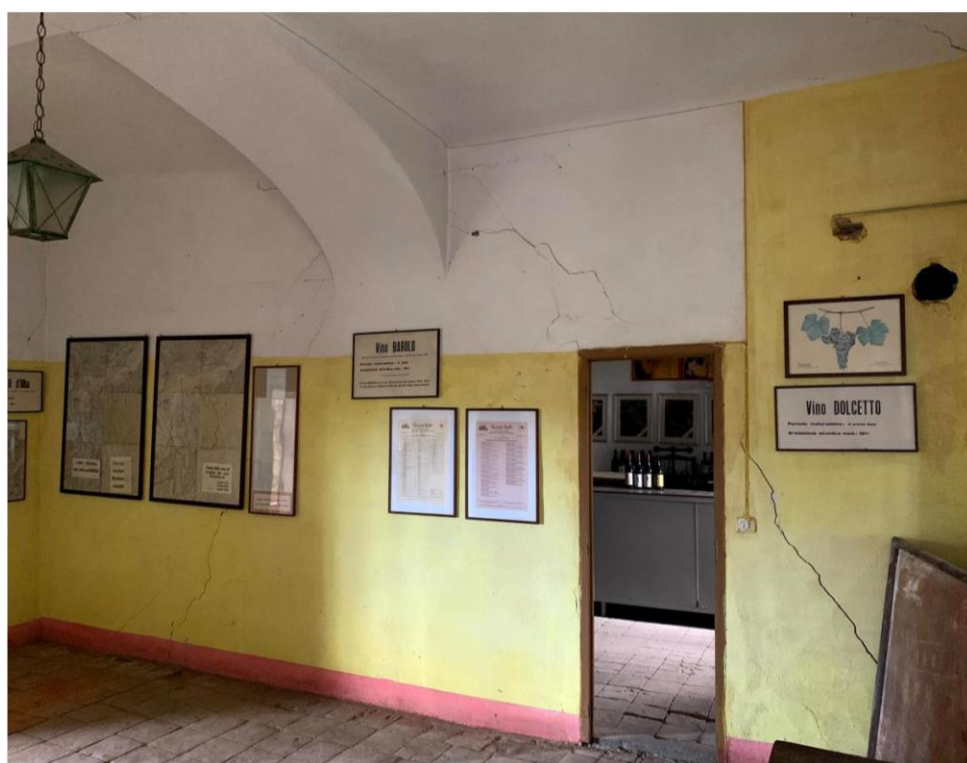
Figura 6 – Criticità riscontrate. Pareti appoggiate "in falso" sulle volte sottostanti. Lesioni sulla parete correlabili alla deformazione della volta di appoggio.
