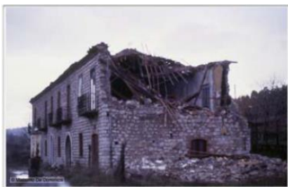
Fig.19. Edificio in muratura danneggiato dal sisma del Friuli
