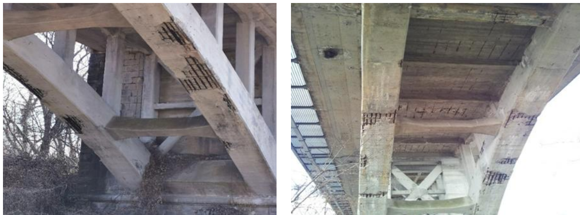
Figg. 2 e 3 Particolari di degrado della struttura prima dell'intervento
