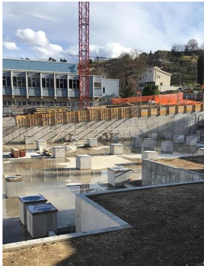
Isolatori sismici - Itis San Severino
