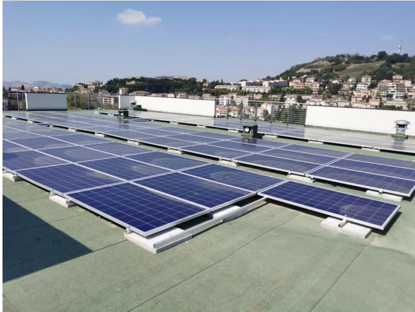
Impianto fotovoltaico - Scuola di Fermo
