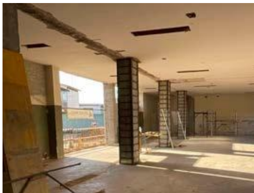
Figura 36 Foto pilastri con cerchiature
