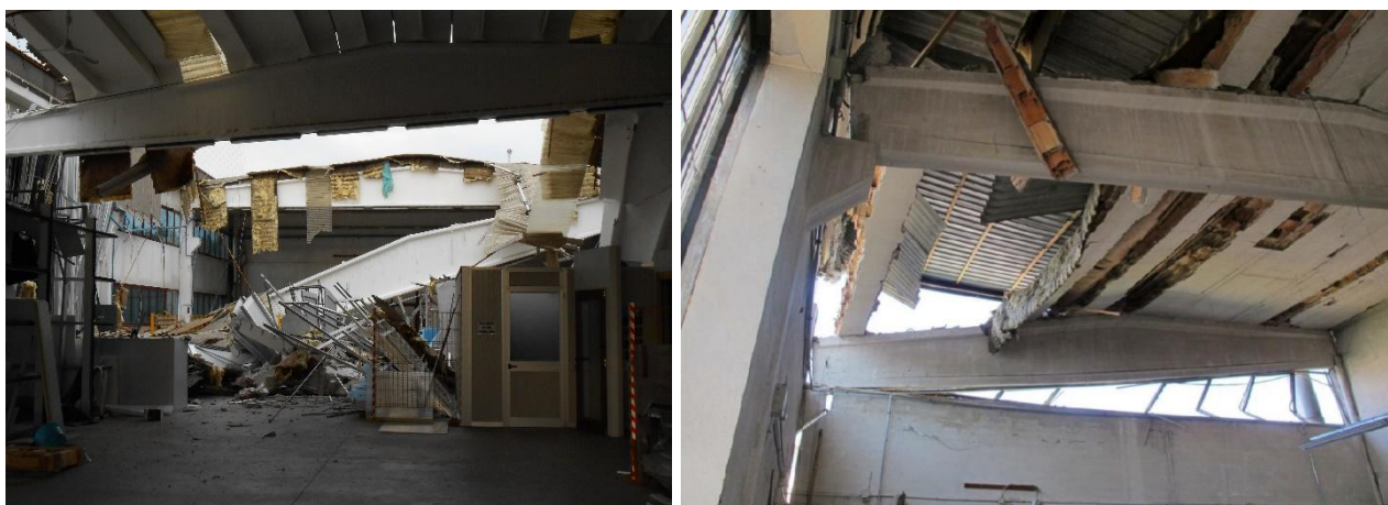
Danni su capannoni prefabbricati derivanti dal sisma del 2012 @Sismocell
