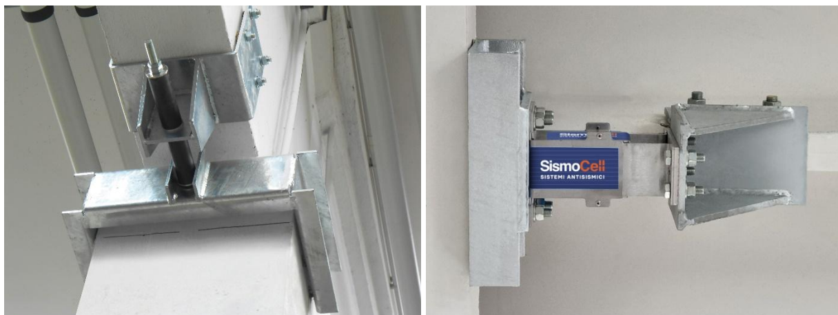
Dispositivi dissipativi Sismocell installati nei nodi di copertura di strutture prefabbricate @Sismocell
