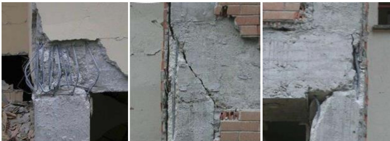
Fonte RELUIS : CRISI PER ASSENZA DI STAFFE NEL NODO TRAVE-PILASTRO
