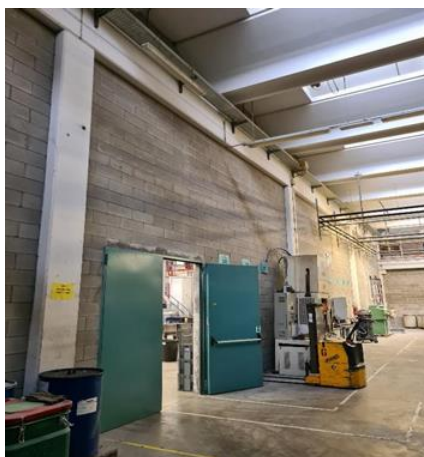
Tamponamento che realizza una compartimentazione antincendio, interferente con la struttura.
