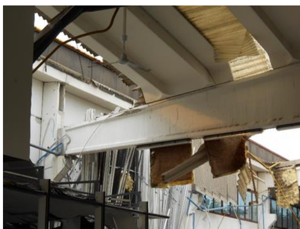
Sisma Emilia 2012 – crollo trave prefabbricata di copertura per effetto dell'irregolarità
