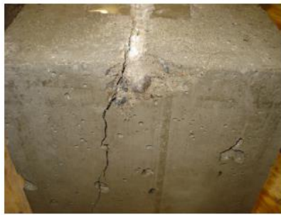
Fessura indotta non passante
