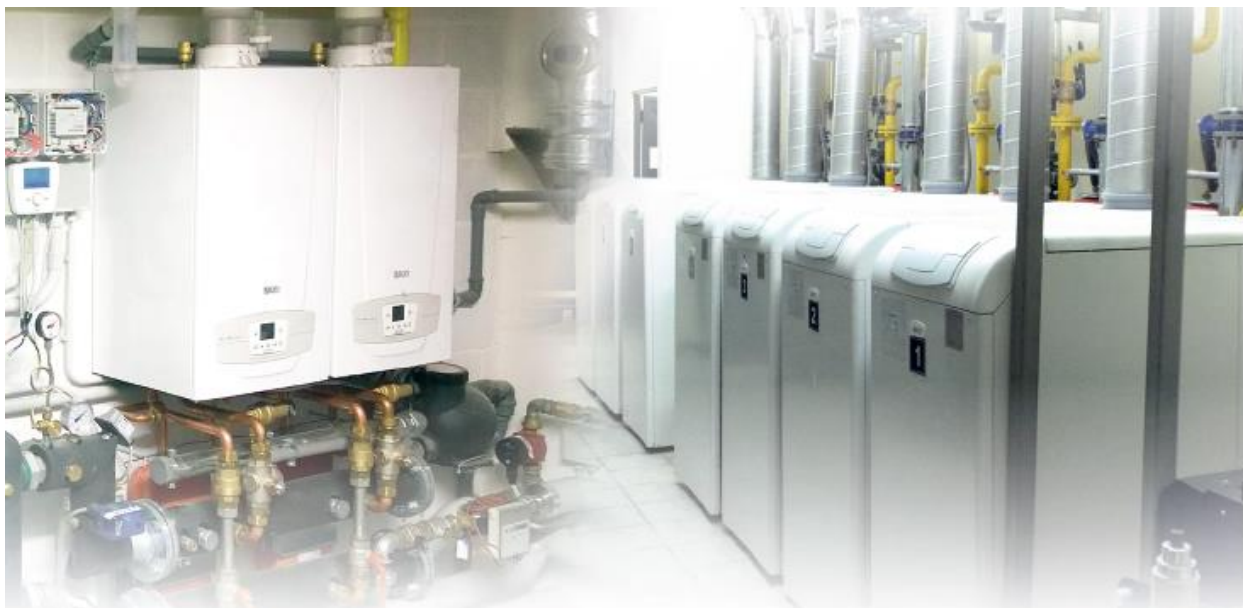
Esempi di centrali termiche Baxi realizzate con caldaie di alta potenza murali e a terra
