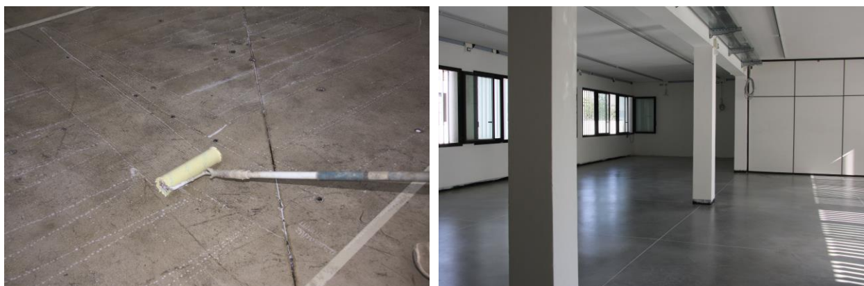
Figura 4 – Trattamento impregnante antipolvere per le pavimentazioni industriali in calcestruzzo realizzato con WEPOX FINITURA: applicazione del prodotto e resa finale della superficie.
