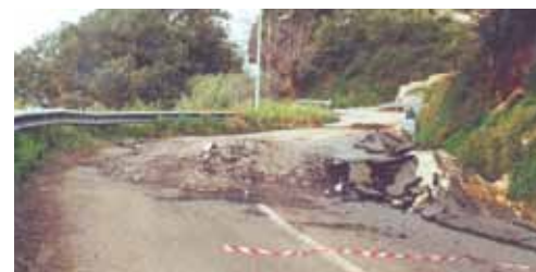
Figura 2 – Strada SS. 18 dir. di accesso a Gizzeria interessata da una frana
