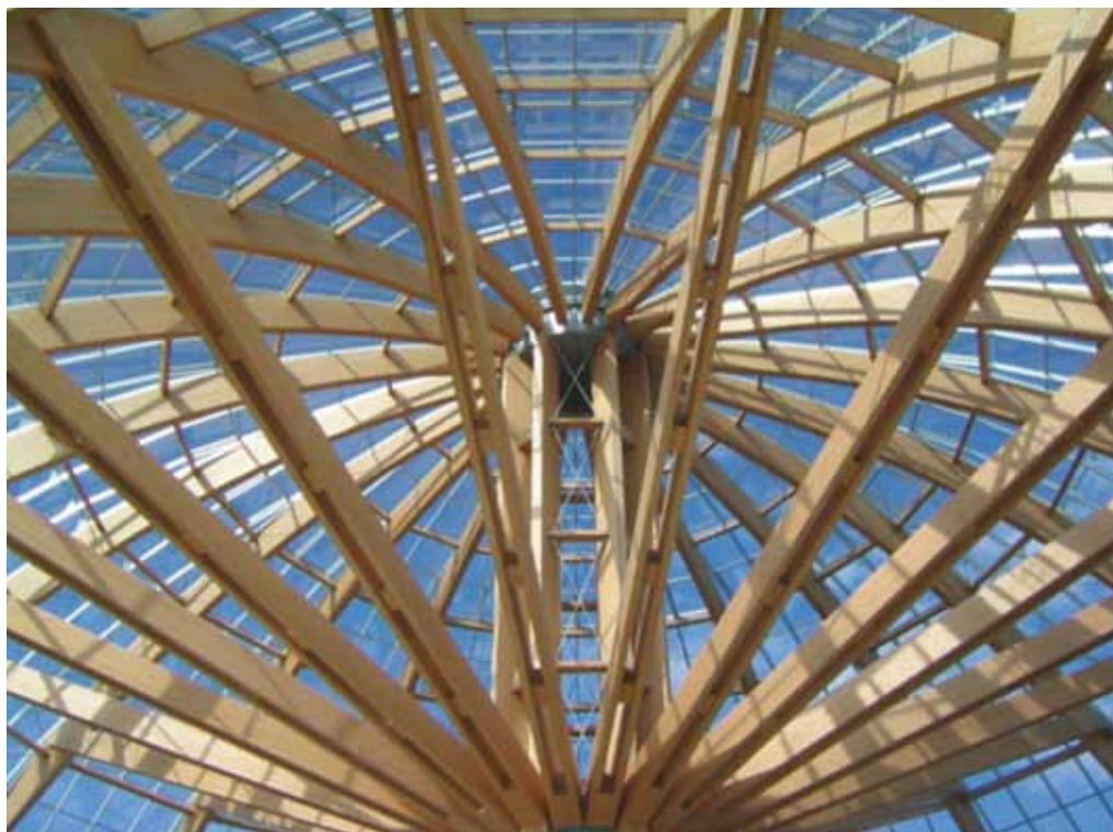
Legno lamellare utilizzato per la sua versatilità architettonica: è una valida soluzione per geometrie complesse (foto Rubner Holzbau S.p.A. di Bressanone)
