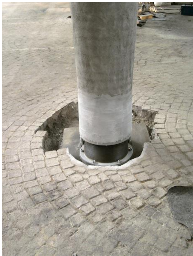
Figura 13. Un pilastro con l'isolatore elastomerico dopo il ritorno elastico alla posizione indeformata.
