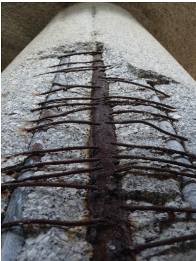
Figura 6. Pilastro "a fungo" del piano pilotis . Deterioramento della corteccia esterna con ossidazione delle barre longitudinali e della spirale trasversale.
