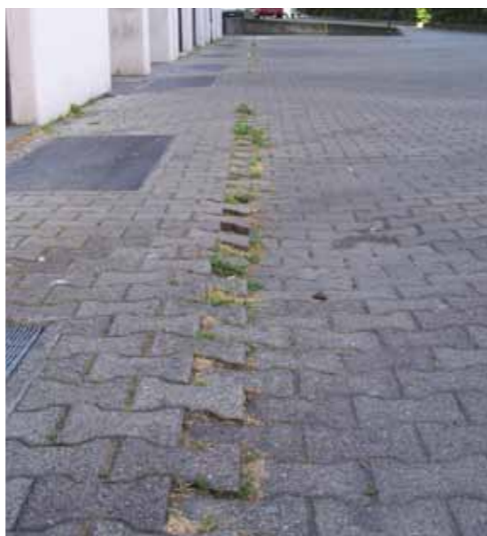
Foto 1 - Masselli posati senza adeguato costipamento del sottofondo
