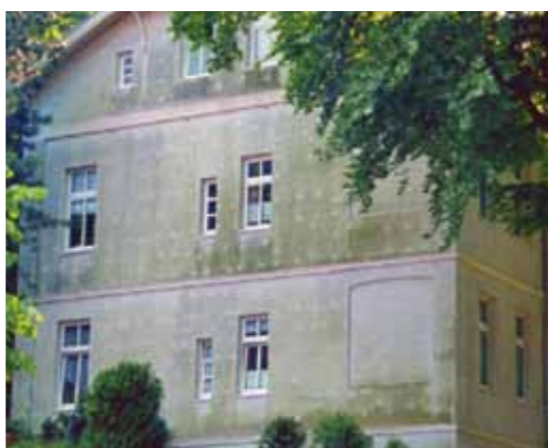
Figura 1 – Tipico degrado algale su facciata con ETICS (External thermal insulation composite systems) – (Germania)
